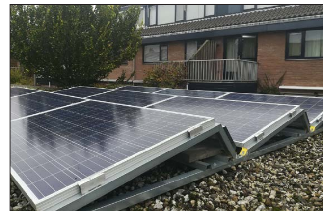
voorbeeld zonnepanelen op garagedaken
