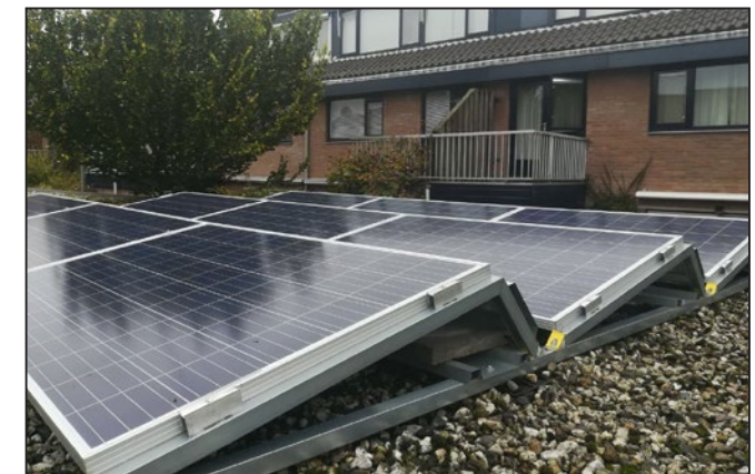
voorbeeld zonnepanelen op garagedaken
